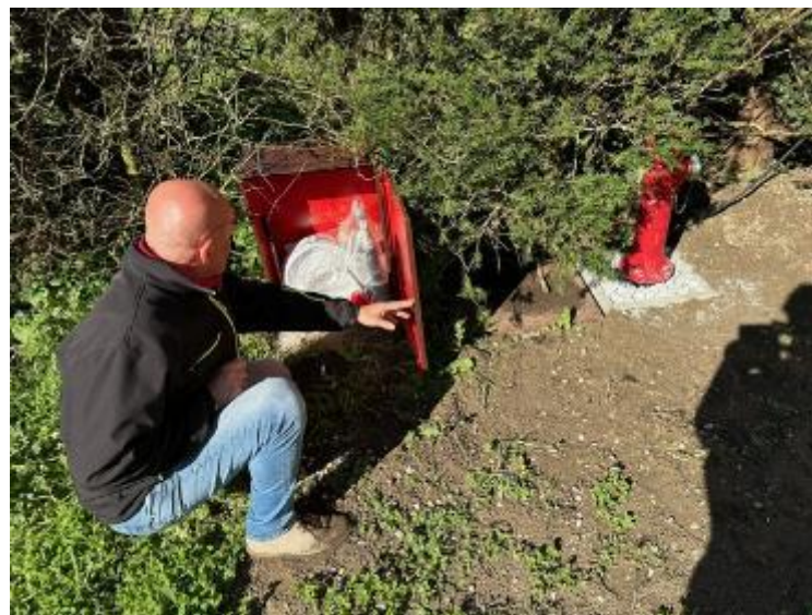
Protegge l'«Insula Pomposiana»: impianti di protezione attiva antincendio per il complesso monastico di Pomposa arch. Serena Ciliani – ing. Tommaso Pazzaglia
