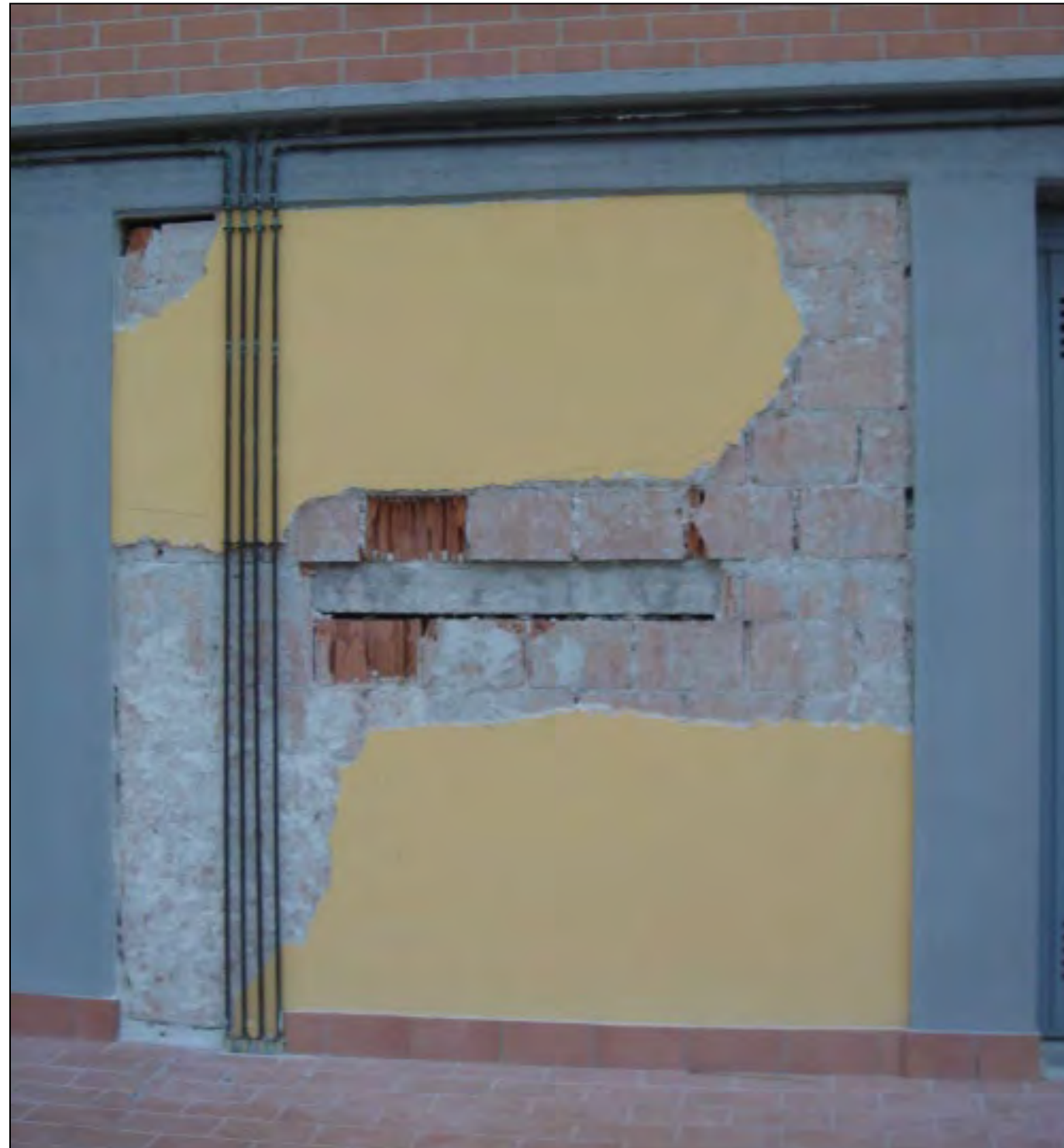
Danneggiamento locale della tamponatura esterna in presenza del pinaerottolo
